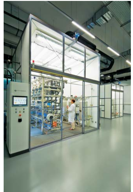
Technikumshalle mit Anlagen zur Membranprüfung und Pilotierung. Im Vordergrund eine Dampfpermeationsanlage gebaut von der Fa. Andreas Junghans in Frankenberg.
