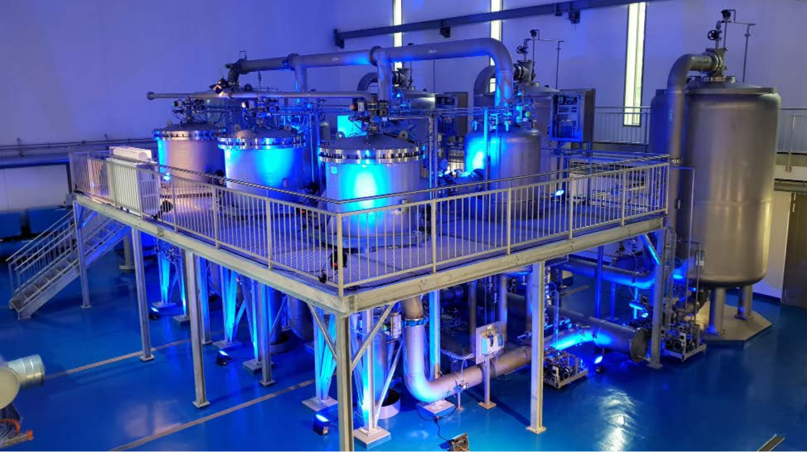
Die Trinkwasseraufbereitungsanlage der ewl energie wasser luzern wurde im Oktober 2018 in Betrieb genommen.
